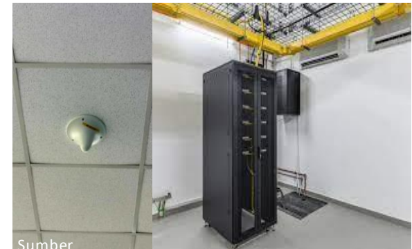
Sumber Antena Sistem IBC
